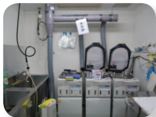
内視鏡洗滌室の換気システム
